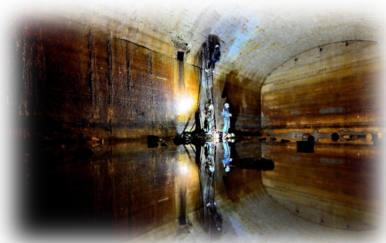
Citerne n°2 l'échelle à poste n'est qu'en partie basse Techniques de corde de descente et de remontée nécessaires
